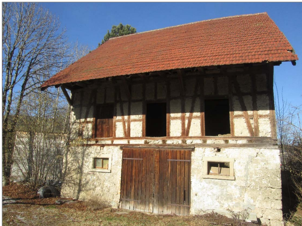
Abbildung 7: Scheune mit großen, unverschlossenen Fenstern; Blick nach Westen (Foto: HPC AG, 26.02.2019)
