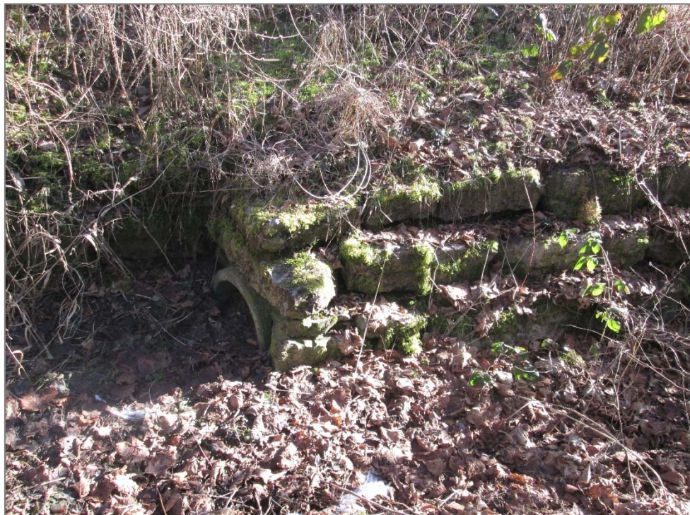
Abbildung 9: Dolenauslass in straßenbegleitendem Graben mit unverfugtem Mauerwerk Lage auf dem nördlichen Nachbargrundstück (F1St. Nr. 73/3), d. h. außerhalb des Planbereichs; Blickrichtung nach Norden. (Foto: HPC AG, 26.02.2019)
